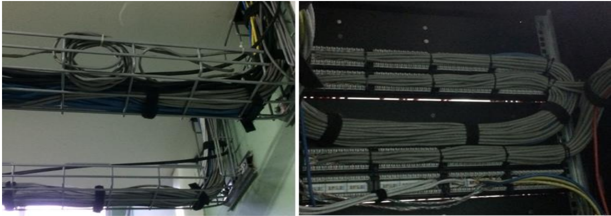
Figura 21. Canasta de cableado. (Meza, 2016).
