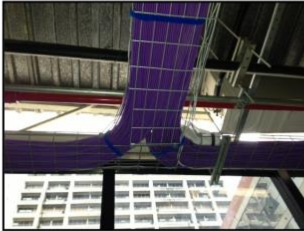
Figura 9. Escalerilla para cable. (Montero, 2014).
