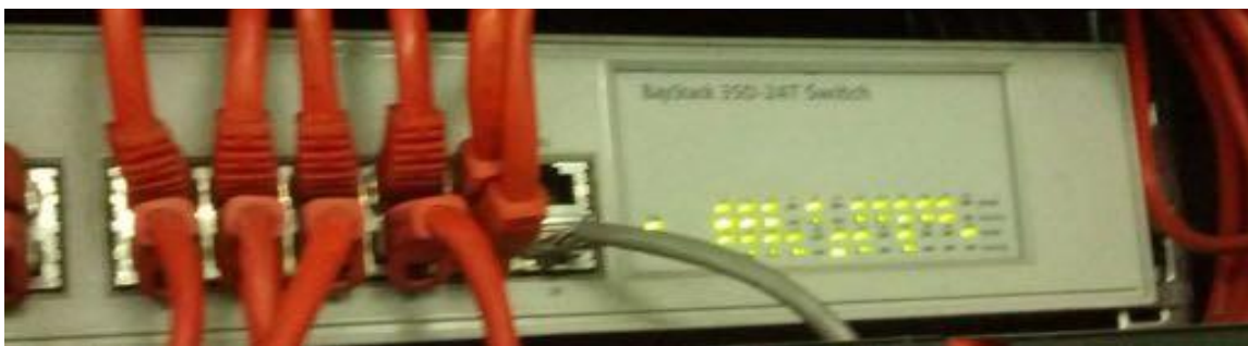
Figura 18. Switch Nortel Bay Stack 350 24 puertos, segundo piso, oficina Servicio al Cliente. (Meza, 2016).
