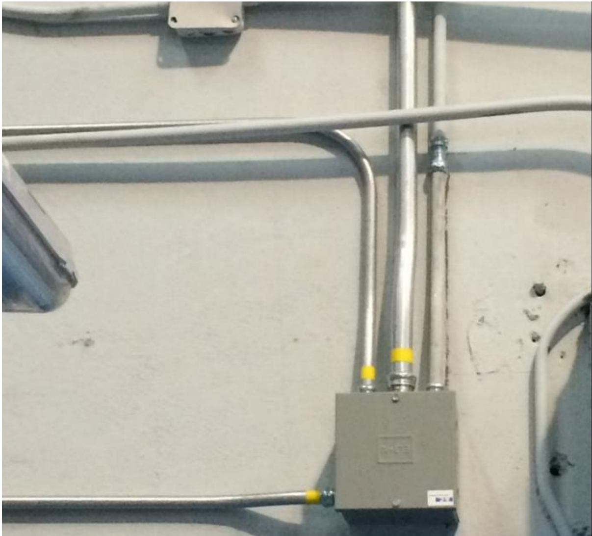
Figura 53: Foto de tubería del cableado de la bodega. (Meza, 2016).
