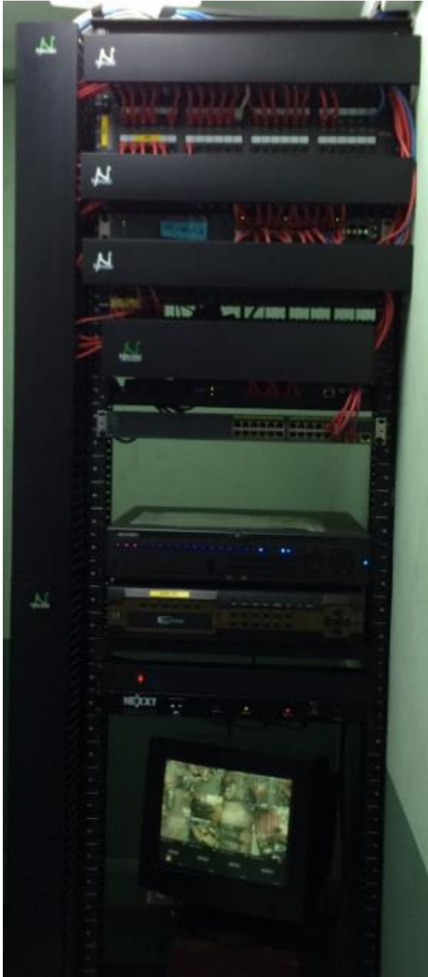
Figura 51: Gabinete ubicado en la bodega. (Meza, 2016).
