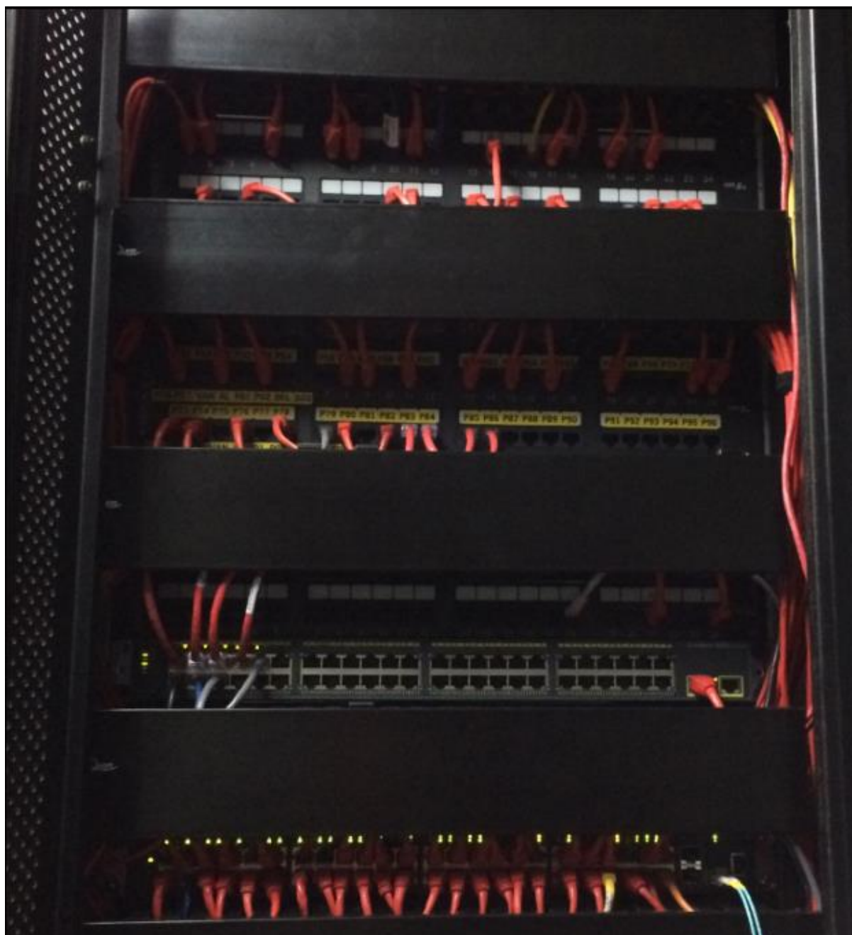
Figura 52: Gabinete ubicado en el cuarto de datos. (Meza, 2016).
