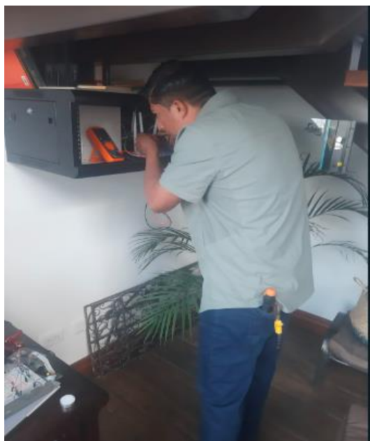
Figura 41 Instalación Centralizada en el gabinete.
