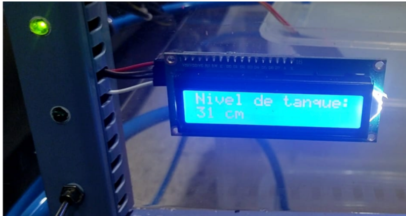
Ilustración 2 Nivel de tanque.
