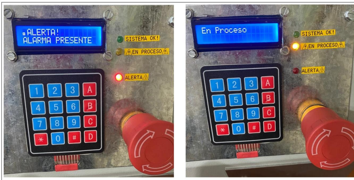
Figura 54. Revisión de luces de señalización.
