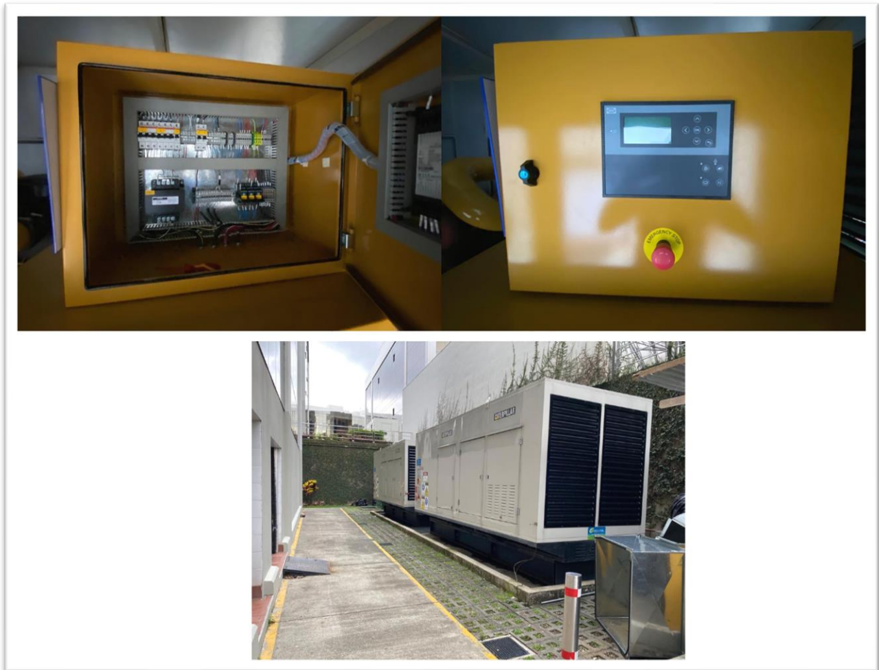
Figura 5. Tablero de control para sincronía de generadores.
