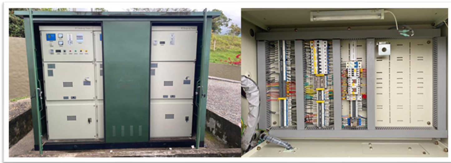
Figura 4. Tablero de control para transferencia eléctrica tipo subestación de media tensión, (gabinete ubicado en la esquina superior izquierda del equipo).
