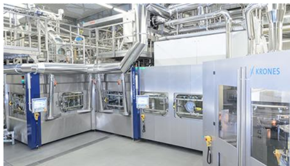
Figura 3: Vista externa de los espacios libres de contaminación para producción de bebidas o alimentos.
