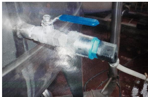
Figura 13: Transductor de nivel por presión hidrostática.
